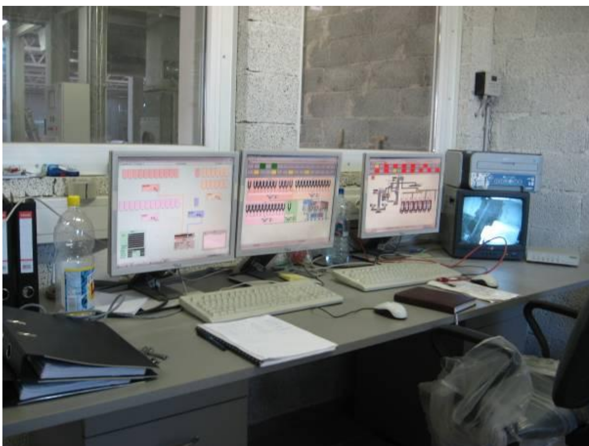
Кедайняй. Завод ССС «SAKRET». В цеху. Пост мастера смены. Пульт управления производством.
