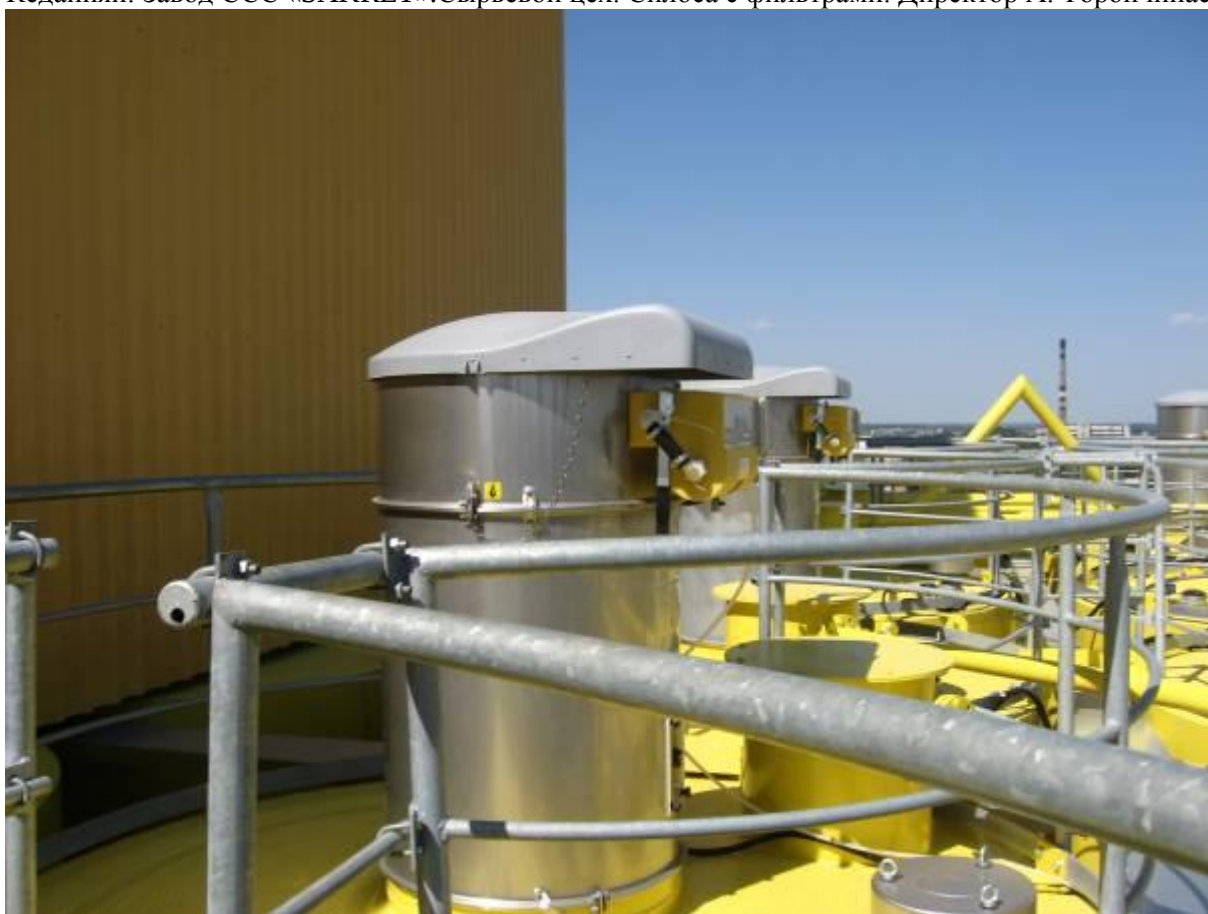
Кедайняй. Завод ССС «SAKRET». Сырьевой цех. Силоса с фильтрами.
