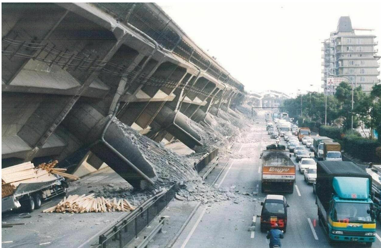
Скоростное шоссе, разрушенное землетрясением в Kobe Фото Weebly
